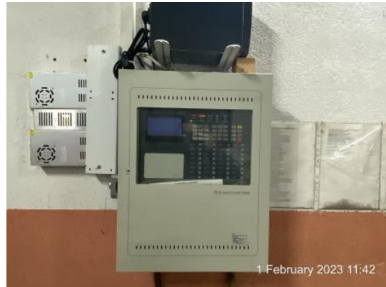
Fire alarm system.JPG
