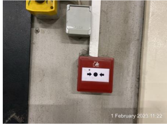
Fire alarm button.JPG
